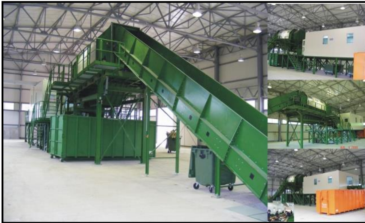
Instalație de balotare
