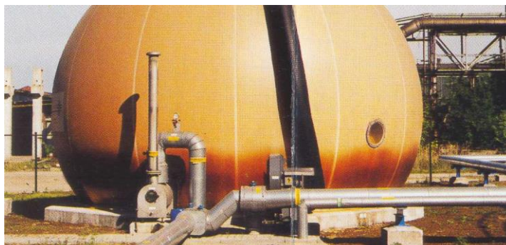
Figura 11.43. Echipament de stocare a biogazului
