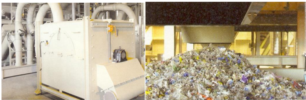
Figura 11.22. Vedere instalatie de purificare mecanica si materialul rezultat
