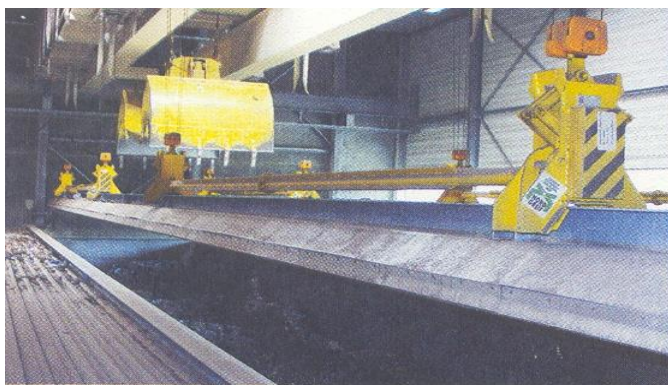
Figura 11.47. Buncar de uscare biologică a deșeurilor
