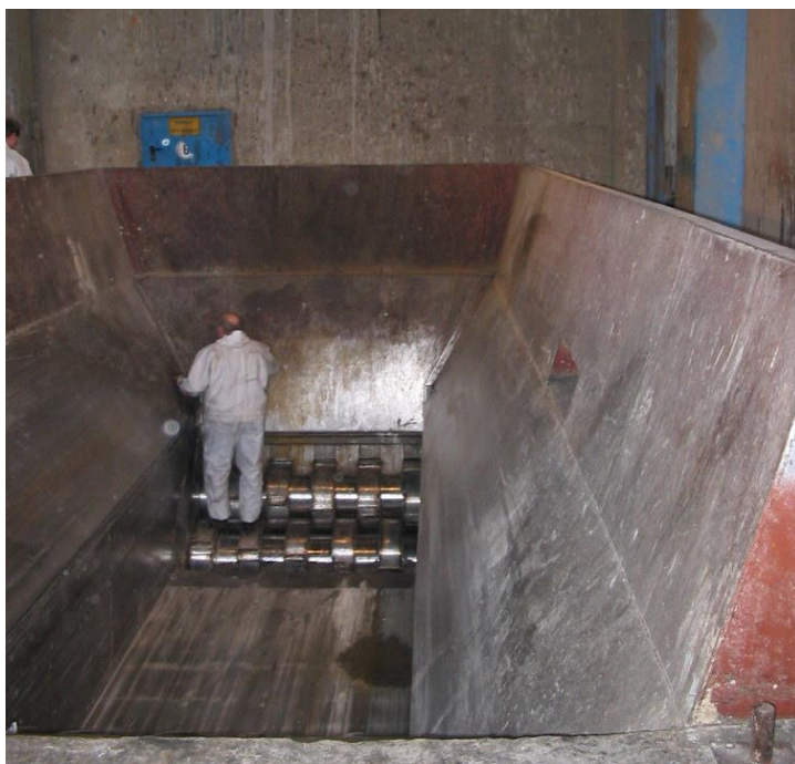
Figura 11.53. Exemplu de dispozitiv de maruntire a deseurilor voluminoase, chiar in rampa de descarcare
